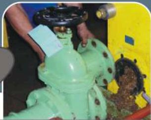
Equipamento de uma usina hidrelétrica infestado de mexilhões dourados
