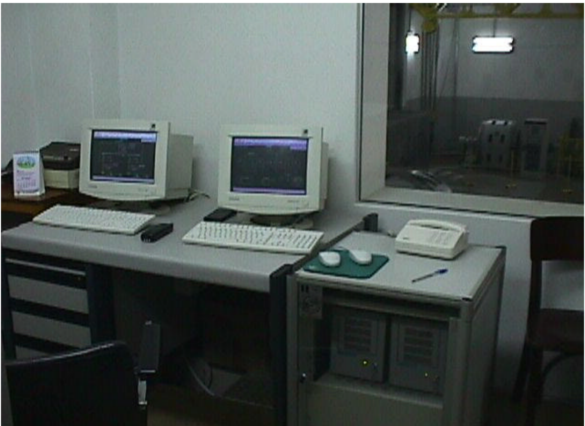
Sala de comando - automatizada
