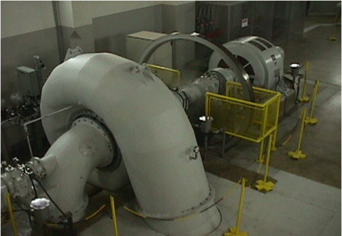
Sala de Máquinas
