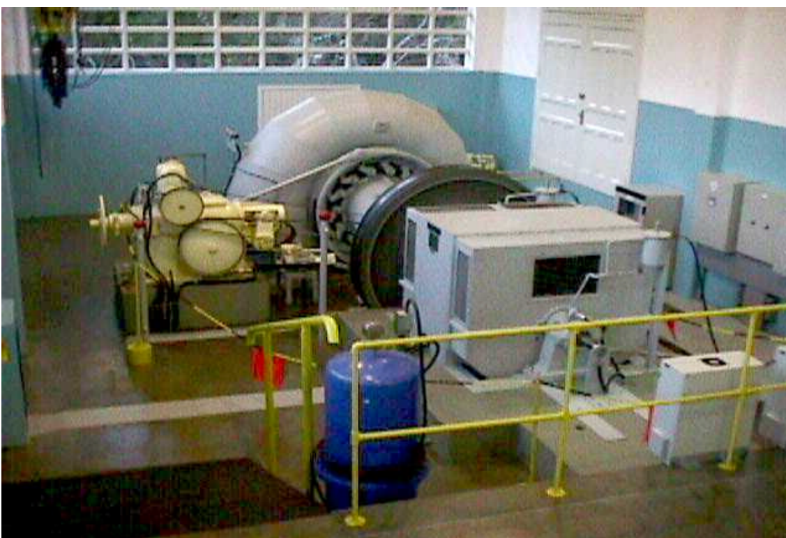
Sala de máquinas
