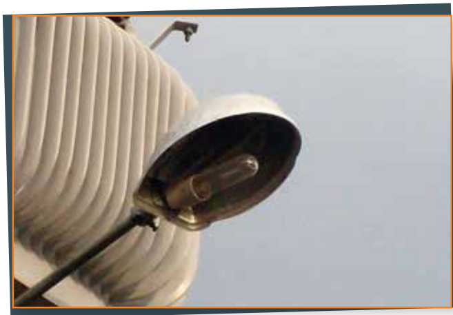
Figura 13 - Luminária inadequada para utilização em iluminação pública.
