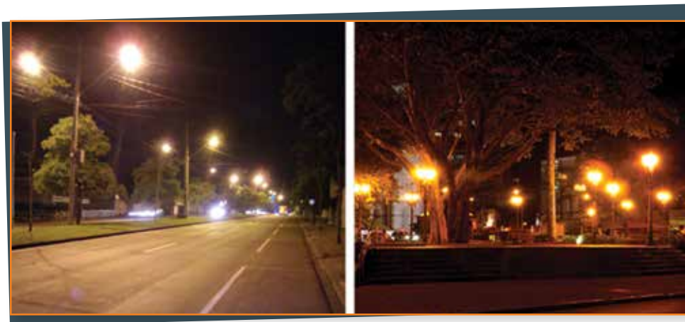
Figura 21 - Via coletora com canteiro central iluminada com luminárias integradas e lâmpadas a vapor de sódio 250W.
