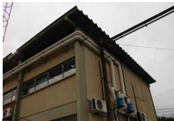
Além das cisternas, foi instalada uma grande tubulação para captação da água da chuva
