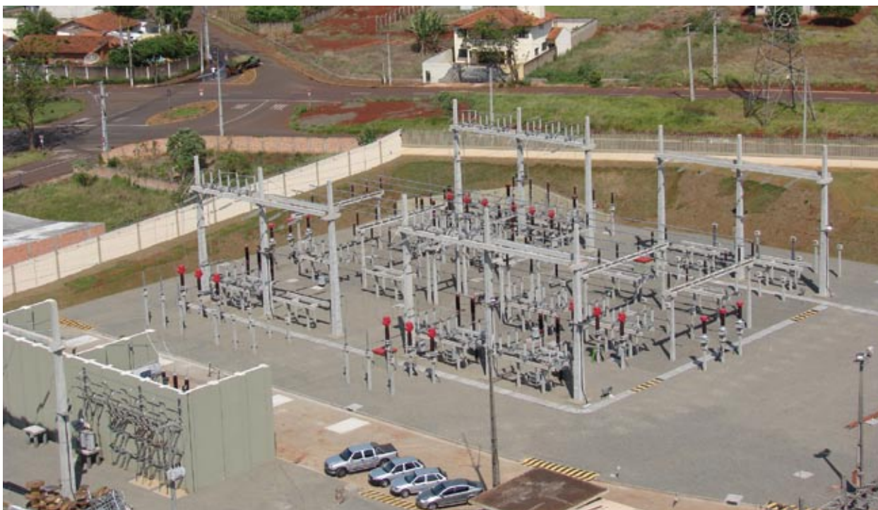
A NOVA SUBESTAÇÃO IGAPÓ, NA REGIÃO URBANA DE LONDRINA, REFORÇA AS CONDIÇÕES DE ATENDIMENTO E MELHORA A QUALIDADE DOS SERVIÇOS DE ENERGIA ELÉTRICA EM 40 BAIRROS, SITUADOS NOS QUADRANTES SUL E OESTE DA CIDADE
