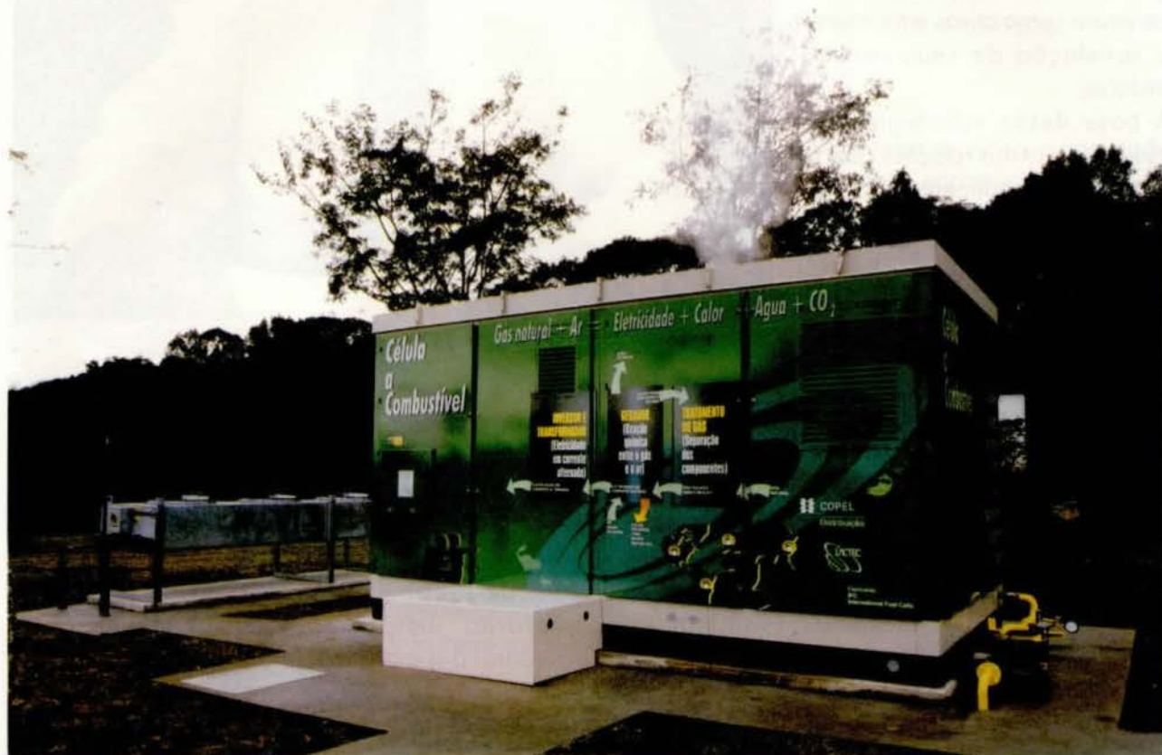
Célula a combustível instalada no Pólo do Km3
