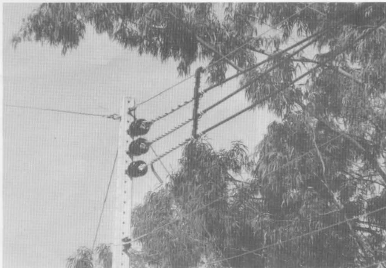
A rede compacta reduz em 20 vezes a poda das árvores
