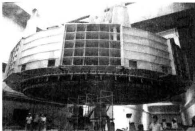
Estator do gerador
