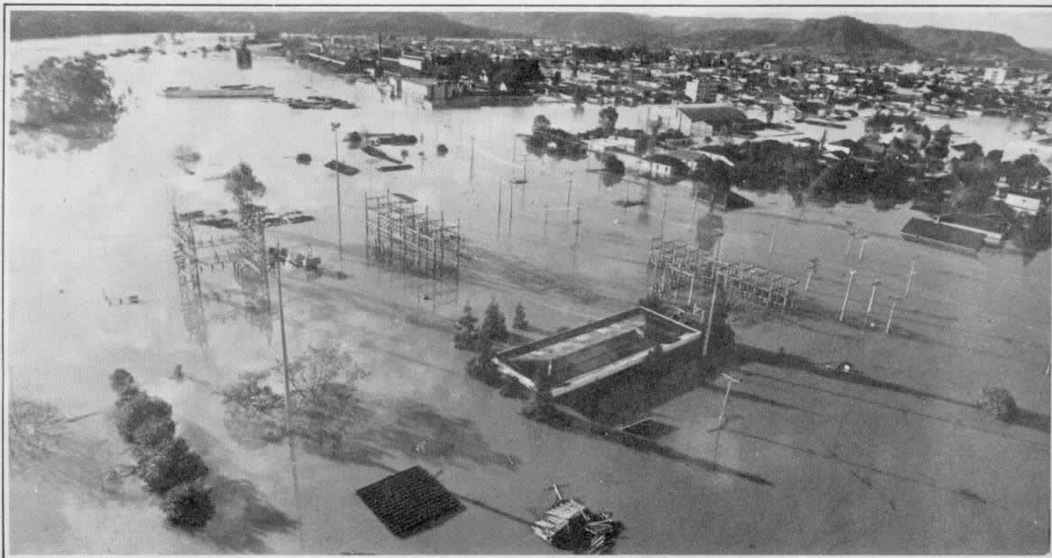
A subestação que atende toda a região de União da Vitória ficou parcialmente submersa:
