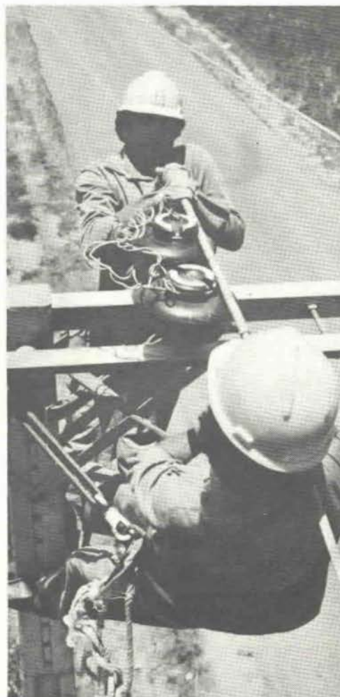
A dificuldade para retirar o isolador, sem o uso do equipamento.
