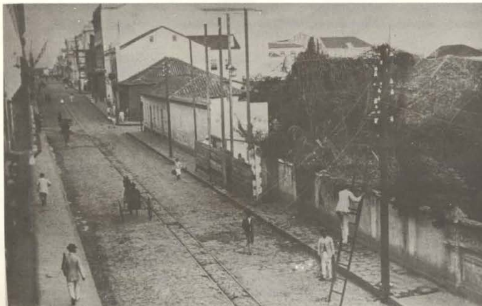
1912: aspecto da Rua XV de Novembro, em Curitiba, atual Rua das Flores. Dois eletricitistas efetuam reparos na Rede de Distribuição.
