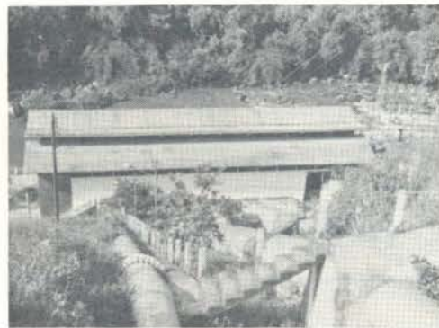
Vista dos condutos forçados e da Casa de Força.
