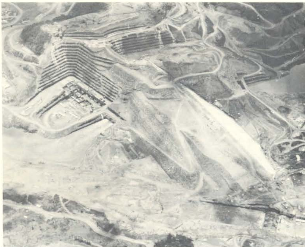
A edificação da barragem atingiu a sua 1ª fase; nessa etapa, a face à montante acha-se já totalmente concretada.
