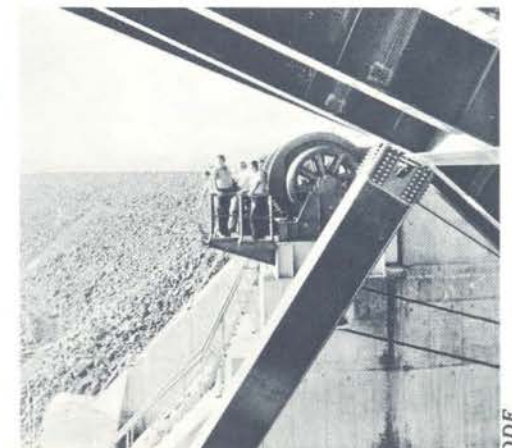
Em Salto Osório, a constatação da magnitude da obra, levantada pela Copel.
