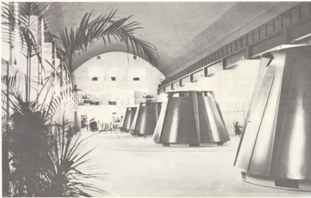
Hidrelétrica Governador Parigot de Souza, a mais importante unidade geradora da COPEL e a maior do Sul Brasileiro. Com a central de geração encravada na rocha, a aproximadamente 800 metros abaixo do Rio Capivari e a 1.500 metros da encosta da Serra do Mar, é a segunda no gênero existente no País (a primeira está em Cubatão).
